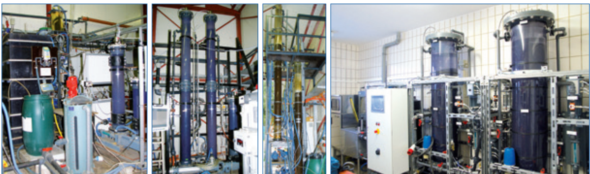
Abb. 17: Pilotanlagen zur Entfernung anthropogener Spurenstoffe (von links nach rechts): MBR mit teilintegrierter Ozonung, Ozonanlage zur Aufbereitung konventionell biologisch behandelten Abwassers, der Ozonanlage nachgeschaltete Aktiv- und Biofilter, Reaktoren zur Anreicherung von Eisenbakterien.
