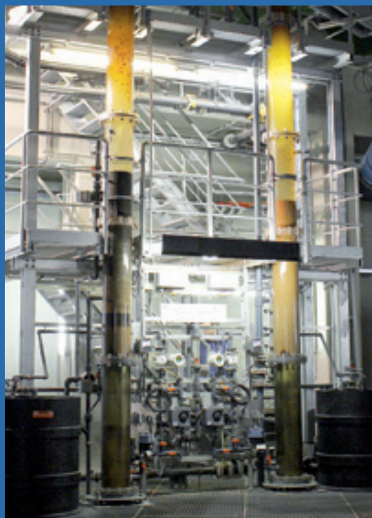
Abb. 13: Forschungsfilter in der Oberflächenwasseraufbereitungsanlage (OWA) in Tegel, Berlin
