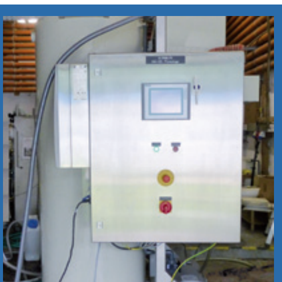
Abb. 14: Erste Stufe der Pilotanlage zur Spurenstoffelimination
