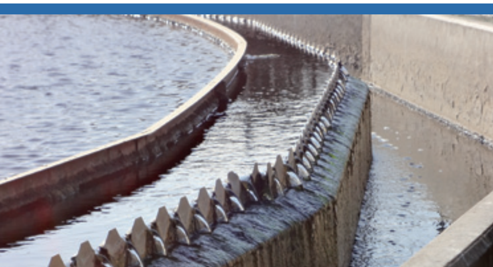
Abb. 22: Ablauf für behandelte Abwässer aus dem Nachklärbecken
